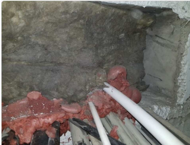
Kuva 2: Väärin tehty palokatko. ( https://fise.fi/virhekortti/vaarin-toteutetut-palokatkojen-korjaustyot/ )
